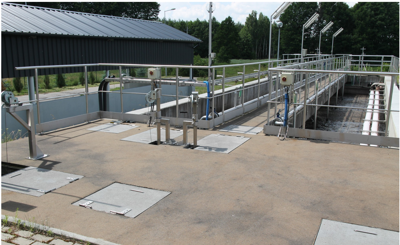
Rys. 18. Oczyszczalnia ścieków kanalizacyjnych w Wierzbicy.
