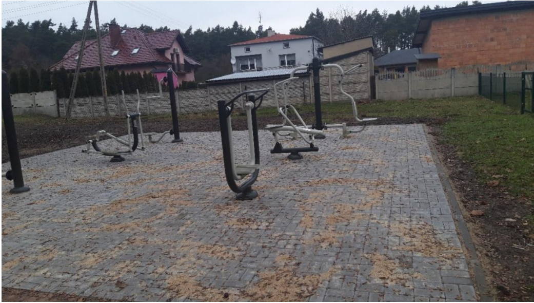
Rysunek 5. Wykonanie utwardzenia z kostki brukowej pod urządzeniami siłowni zewnętrznej w parku w Woli Jedlińskiej
